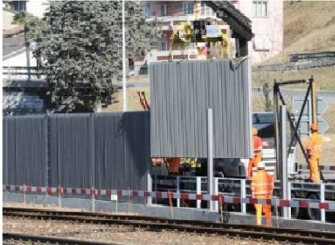
A. Noise Barrier
